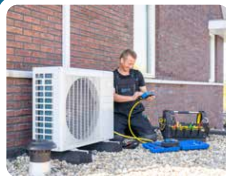
Warmtepompen en warmtepompboilers
